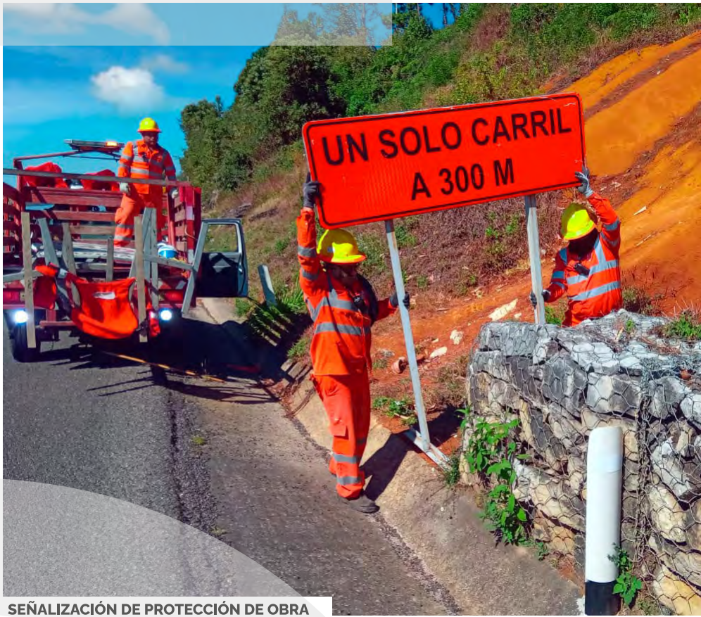
SEÑALIZACIÓN DE PROTECCIÓN DE OBRA
